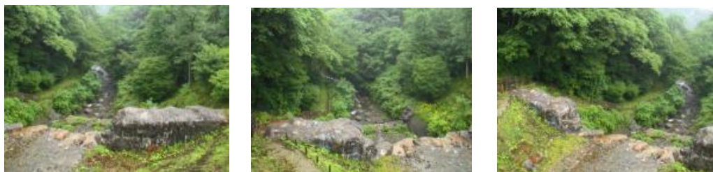
写真1 自然石でできた砂防堰堤
